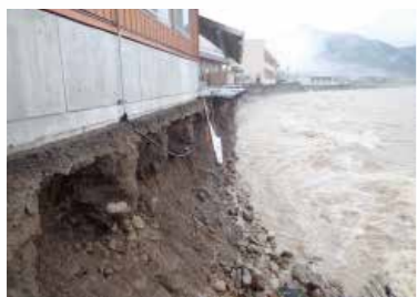
▲護岸が決壊した様子。
